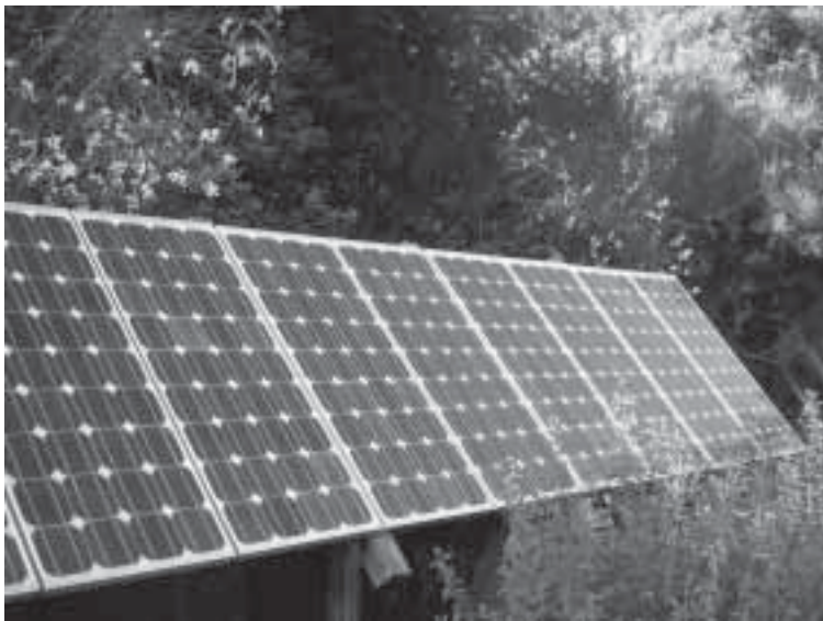
Plaques solars per a l'energia.
