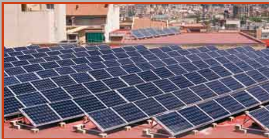
Instal·lació solar FV al mercat del Carmel.
