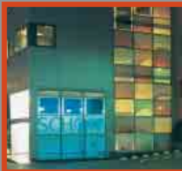
Panell fotovoltaic de color integrat a la façana de l'edifici Schott a Sant Adrià de Besòs.
