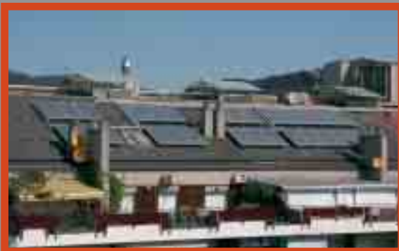
Energia solar tèrmica a l'edifici del carrer Guillem Tell (Barcelona).
